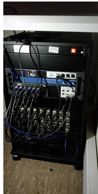
Rack de so a la cabina
